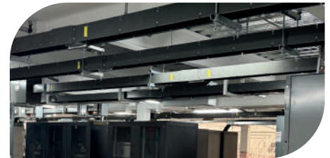
Instalación con electroducto
